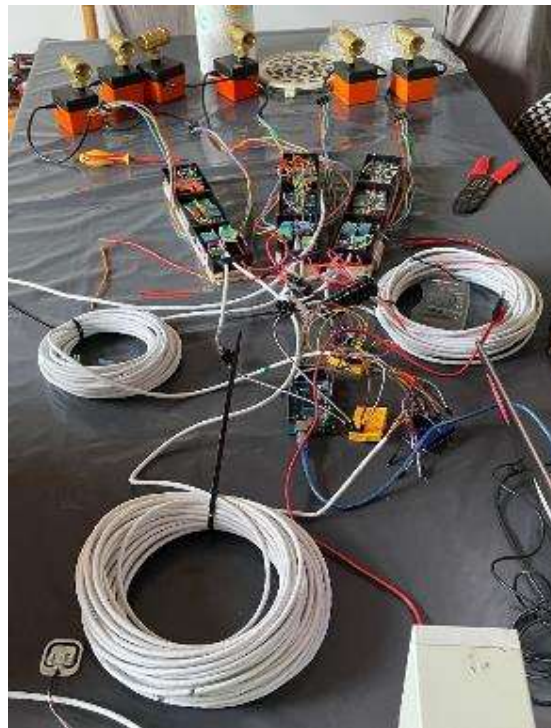
Figure 64 : Photos du système réel et tests des vannes
