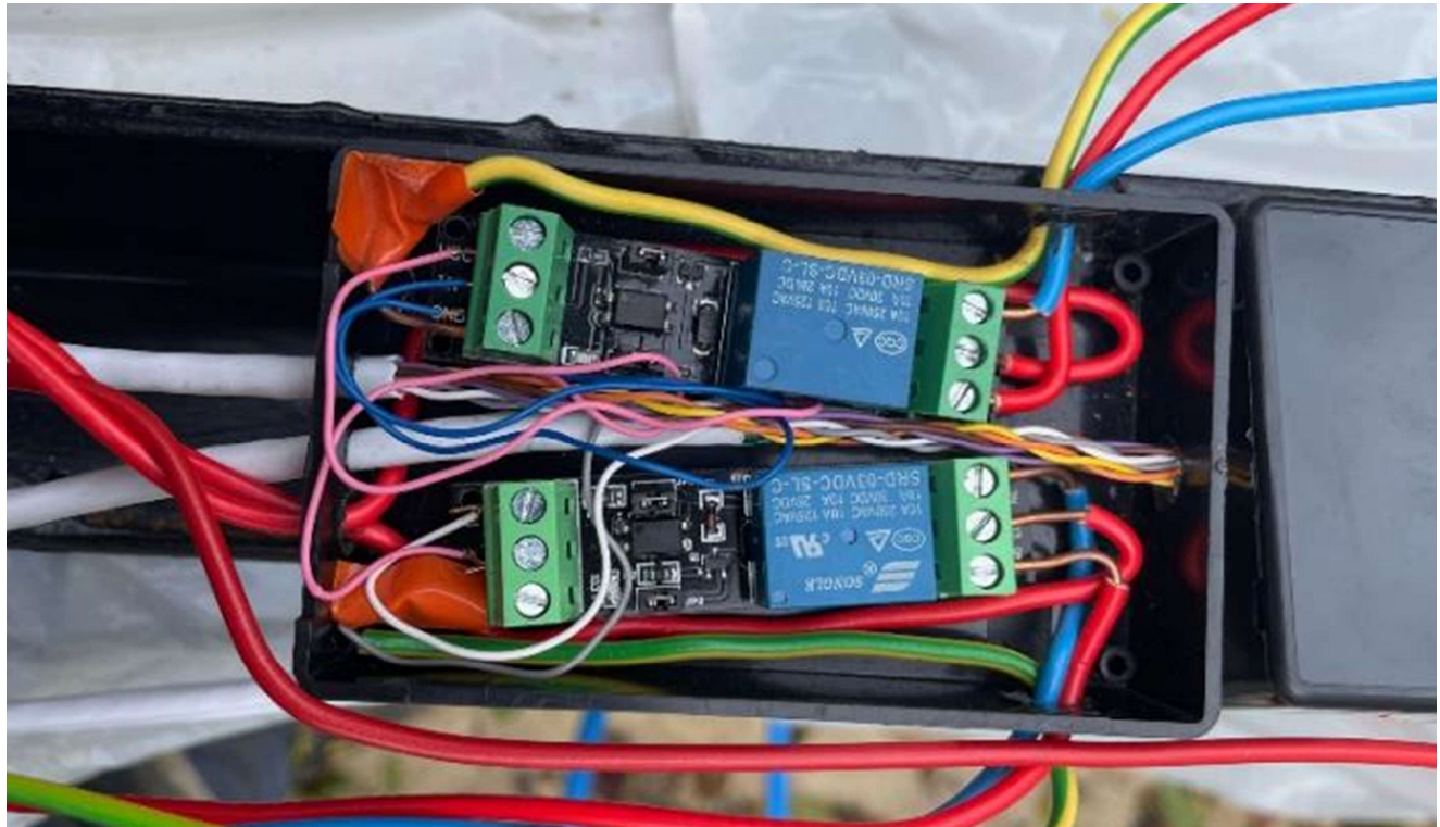
Figure 61 : Croquis et photo du boîtier électronique de pilotage des vannes motorisées
